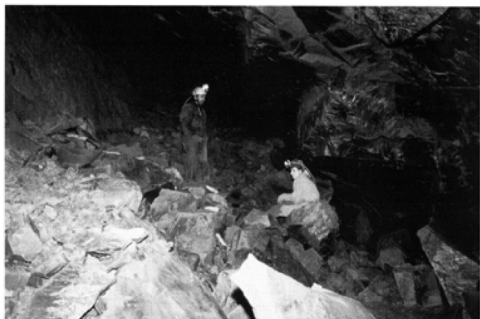
Foto 3 - La sala "terminale" ubicata alla fine della "Galleria del sale". Il crollo del soffitto e delle pareti della galleria appare molto recente, sulle superfici di distacco sono visibili numerose fratture aperte che denotano la totale instabilità dell'area attraversata da una faglia attiva.
